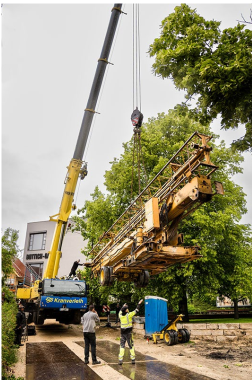
liebherr-ltm1130-5.1-esb-berg-03.jpg Sanfte Landung – der Schnelleinsatzkran 28 K wird auf der Baustellenzufahrt für den Weitertransport abgesetzt.
