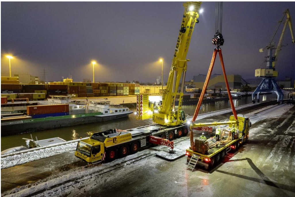
liebherr-ltm1650-8-1-flossdorf-2.jpg Etliche Strahler am Ausleger und Oberwagen des Liebherr-Mobilkrans erlauben sicheres Arbeiten auch bei Dunkelheit.
