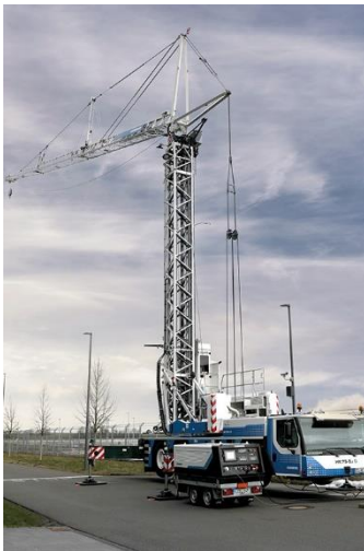
Liebherr-mk-liduro.jpg Ergänzen sich optimal: Mobiler batteriebasierter Energiespeicher Liduro Power Port (LPO) und Mobilbaukran, beides aus dem Hause Liebherr.
