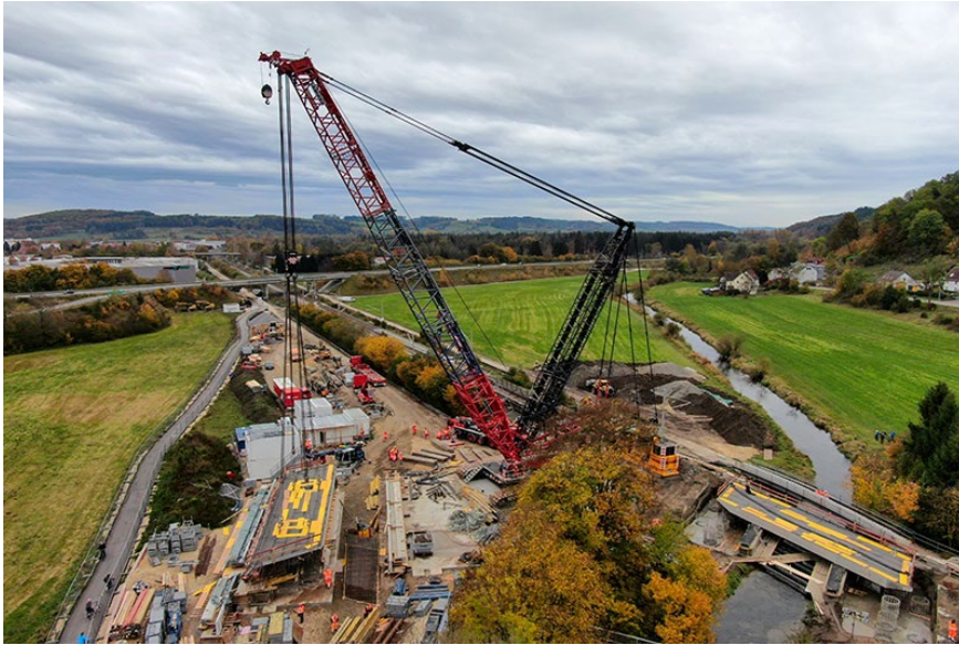
liebherr-lr1750-2-riga-mainz-01.jpg RIGA MAINZ montiert mit einem Liebherr LR 1750/2 zwei Stahlbetonbrückenteile über die Riß bei Biberach.
