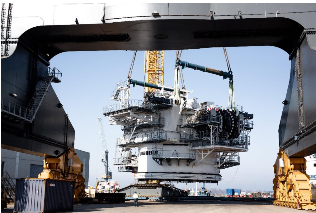
Die Drehbühne und der A-Bock des HLC 150000 wurden auf die BigLift Barentsz gehoben
