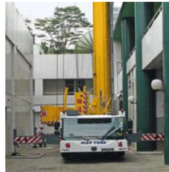
Montage und Betrieb auf engstem Raum aufgrund von 2 Abstützweiten und senkrechtem Turm.
