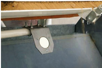
Capteur installé en sortie de silo (goulotte)
