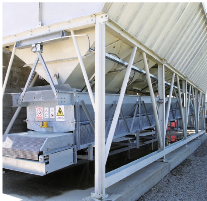
Ленточные весы (оцинкованы) расположены под рядным бункером.
