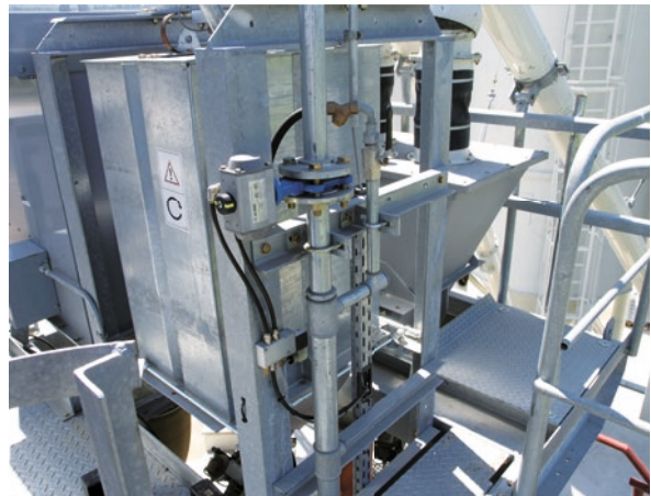
Цементные и водяные весы расположены на весовой площадке, все элементы легкодоступны для обслуживания.
