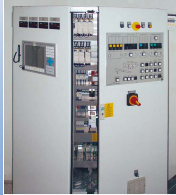
Die Litronic-BCS ist platzsparend im Schaltschrank untergebracht.
