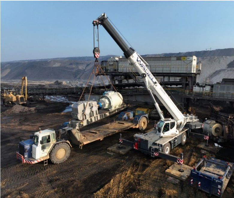
liebherr-ltr-1130-wasel-rwe-03.jpg Im Einsatz: Beim Auswechseln einer über 30 Tonnen schweren Bandantriebsstation im Tagebau Garweiler zeigt der Geländekran, wofür er konzipiert wurde.
